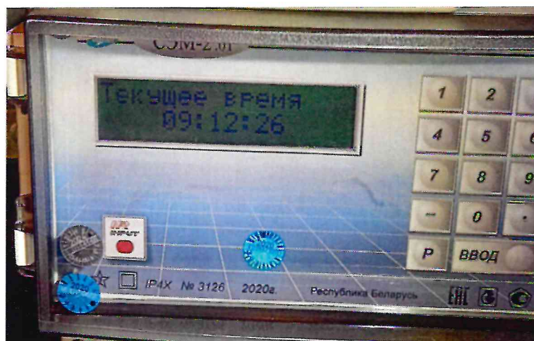
б) сумматор в шкафу учёта АСКУЭ
