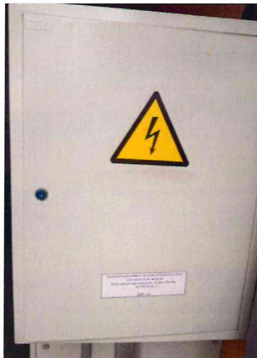
б) шкаф АСКУЭ
