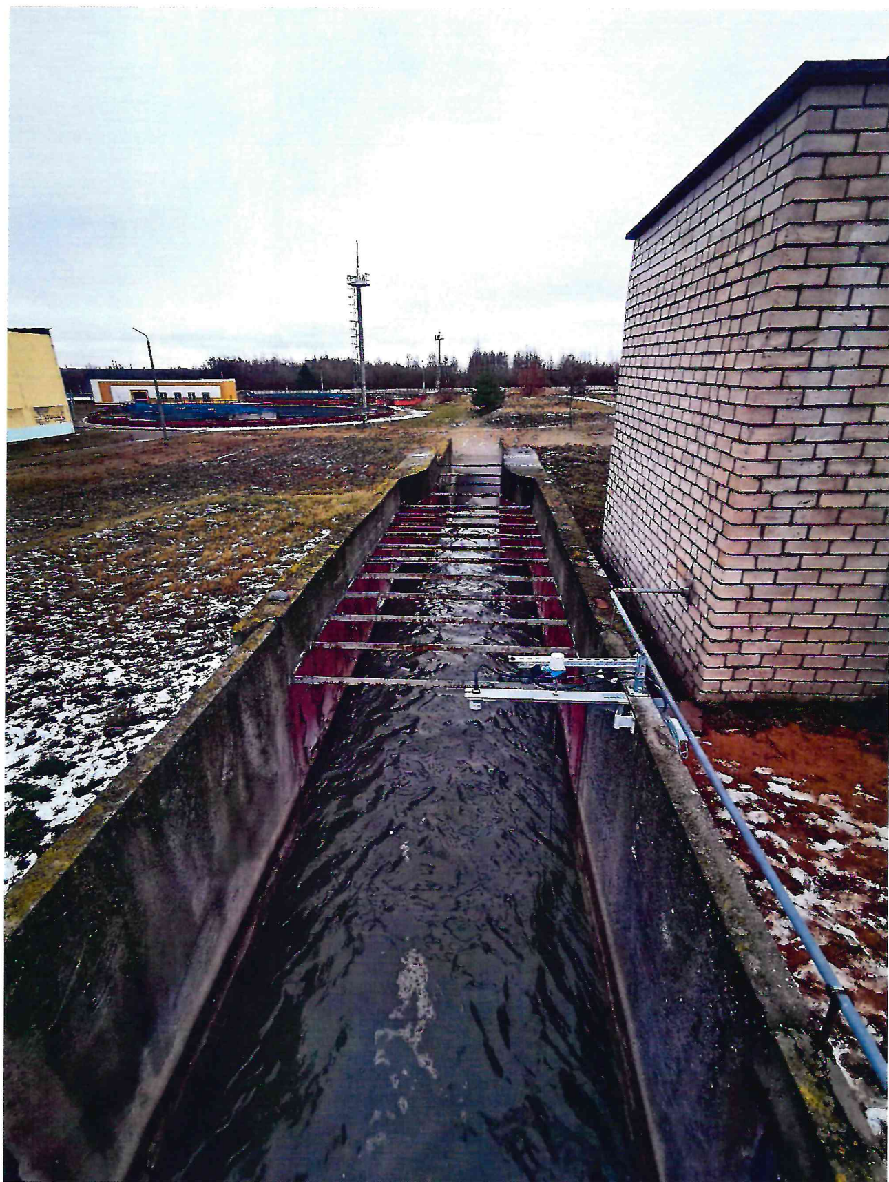
Рисунок 1.7 – Фотография измерительного участка – лотка Вентури входящего в состав узла учета поступающих сточных вод Минской очистной станции № Ц01
