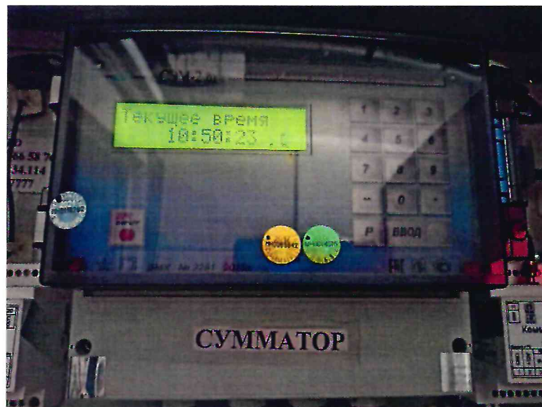
б) сумматор в шкафу учёта АСКУЭ
