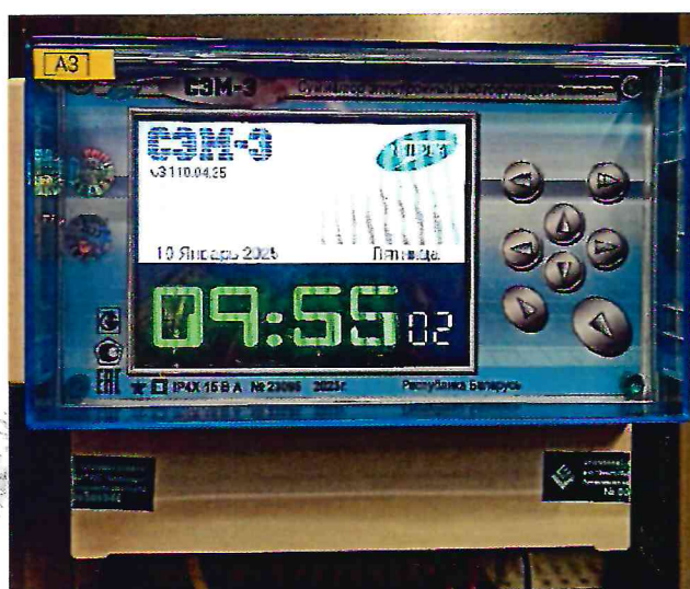
б) сумматор в шкафу учёта АСКУЭ
