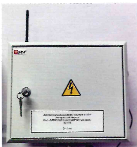
б) шкаф АСКУЭ (КТП-6 завод)
