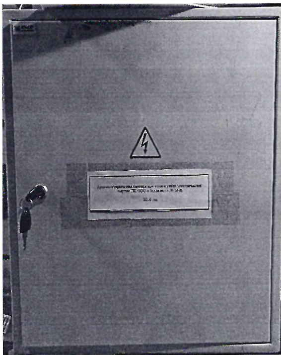
а) шкаф учёта АСКУЭ
