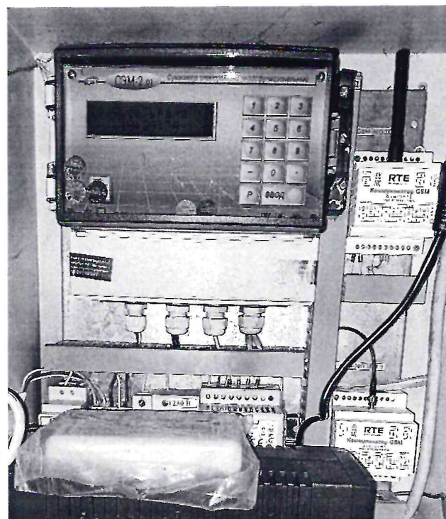
б) сумматор в шкафу учёта АСКУЭ
