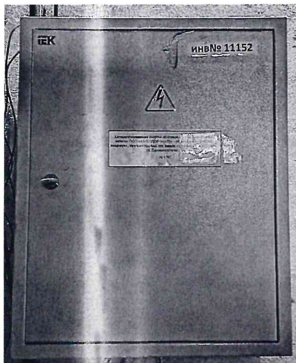
а) шкаф учёта АСКУЭ
