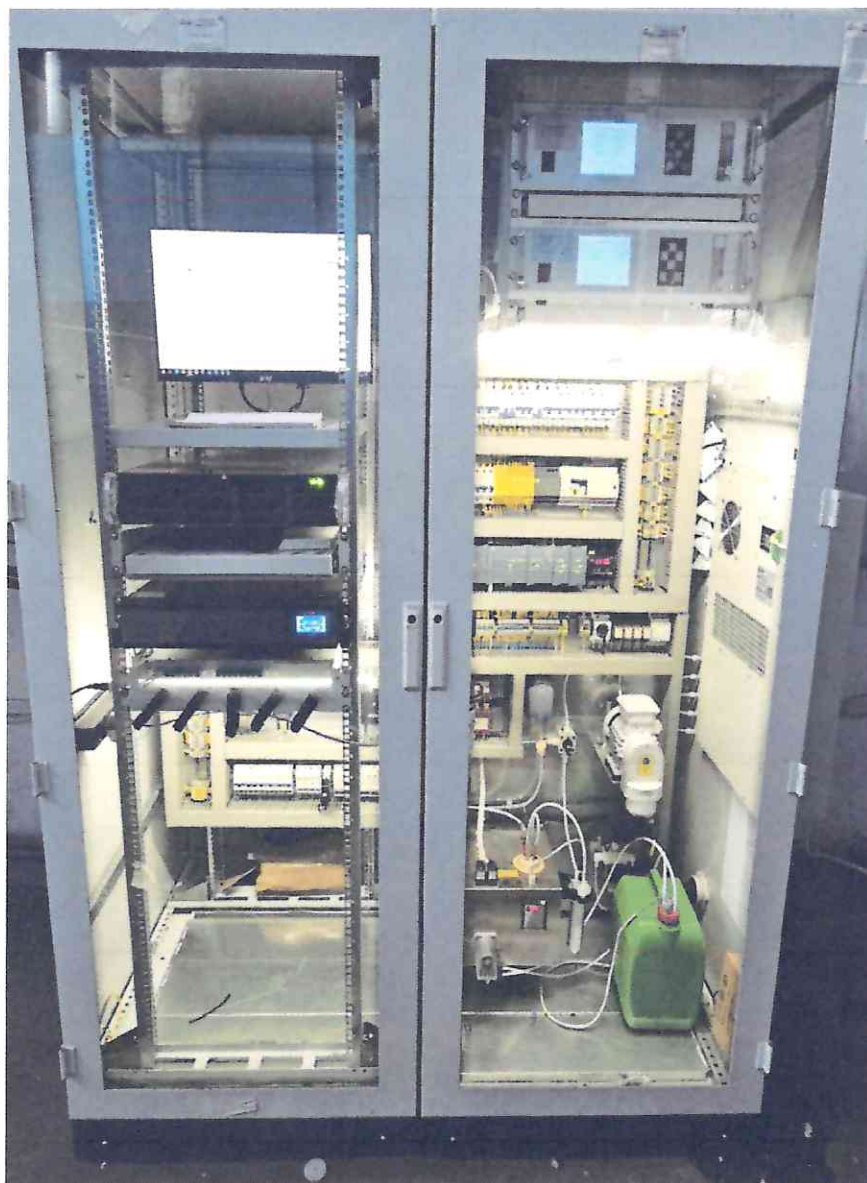
Рисунок 1.9 – Фотография шкаф серверный и шкаф газового анализа
