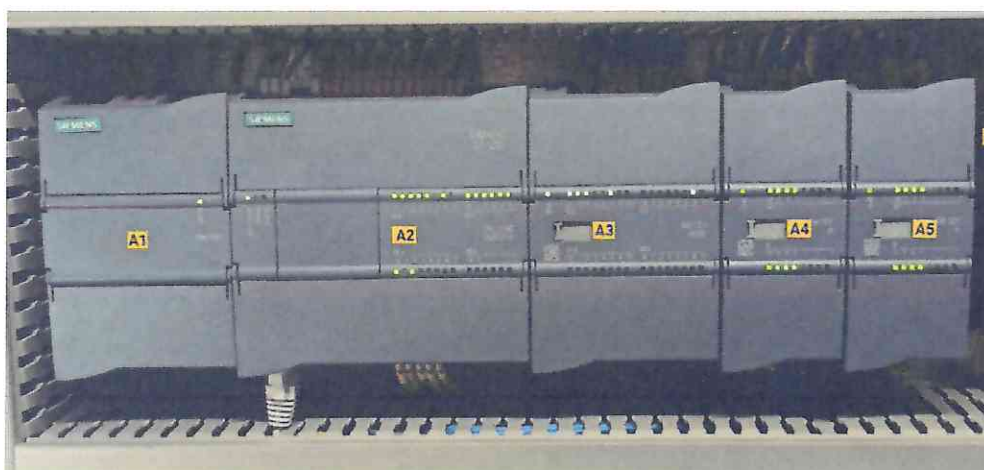
Рисунок 1.7 – Фотография контроллера программируемого SIMATIC S7-1200
