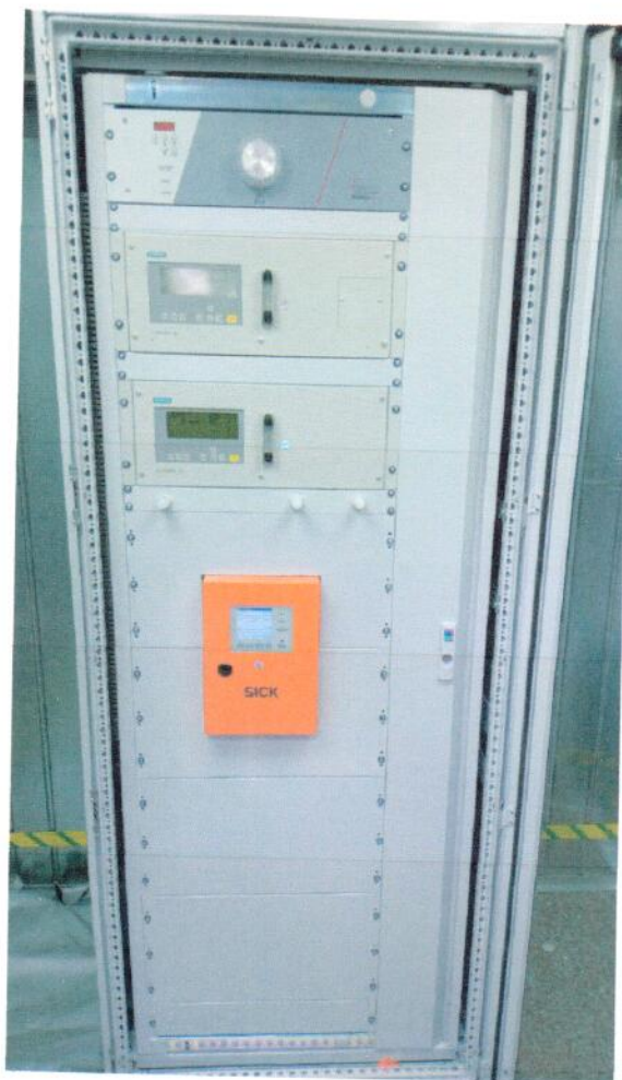
Рисунок 1.7 – Фотография шкафа приборного АСКВ
