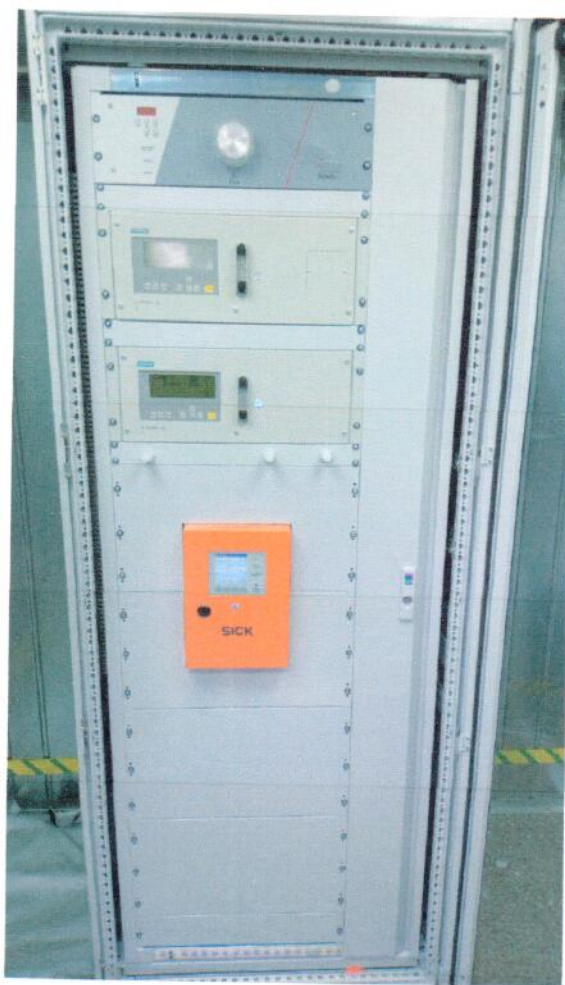
Рисунок 1.7 – Фотография шкафа приборного АСКВ
