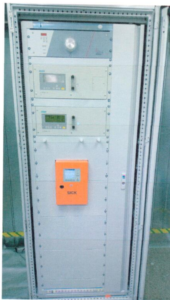
Рисунок 1.7 – Фотография шкафа приборного АСКВ
