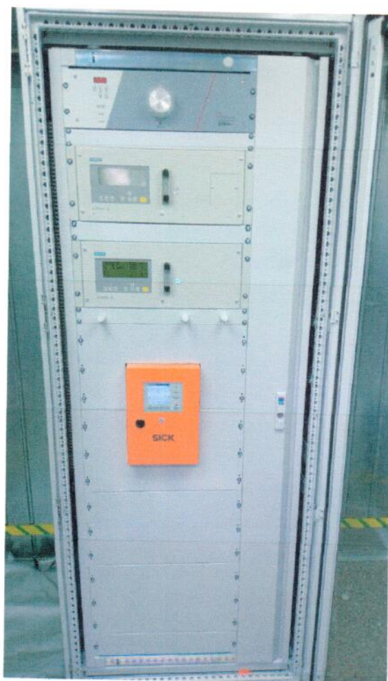
Рисунок 1.7 – Фотография шкафа приборного АСКВ
