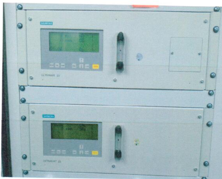
Рисунок 1.1 – Фотография газоанализаторов ULTRAMAT 23
