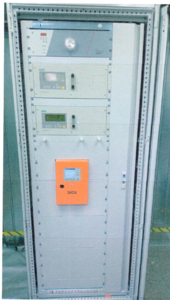
Рисунок 1.7 – Фотография шкафа приборного АСКВ
