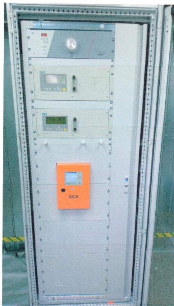
Рисунок 1.7 – Фотография шкафа приборного АСКВ
