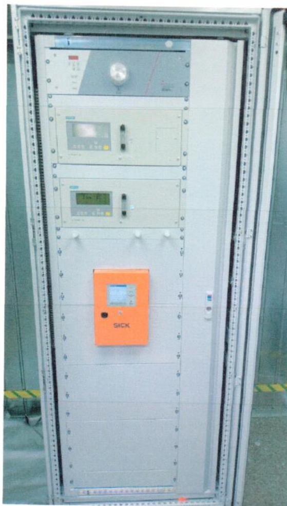
Рисунок 1.7 – Фотография шкафа приборного АСКВ
