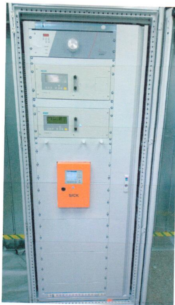
Рисунок 1.7 – Фотография шкафа приборного АСКВ
