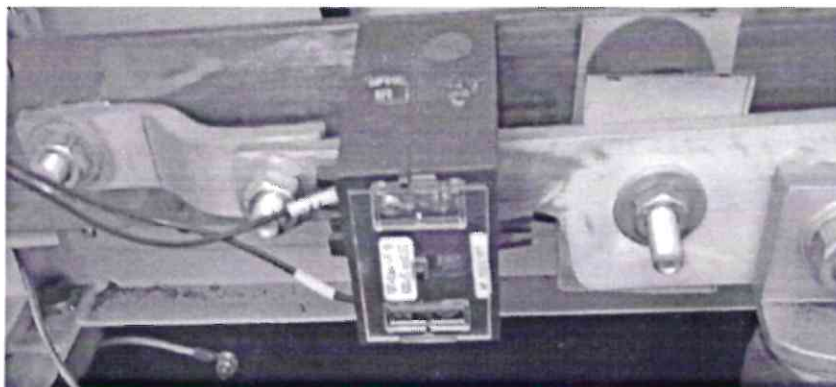
Рисунок 1.5 – Фотография компонентов АСКУЭ при применении трансформаторов тока ТОП-0,66
