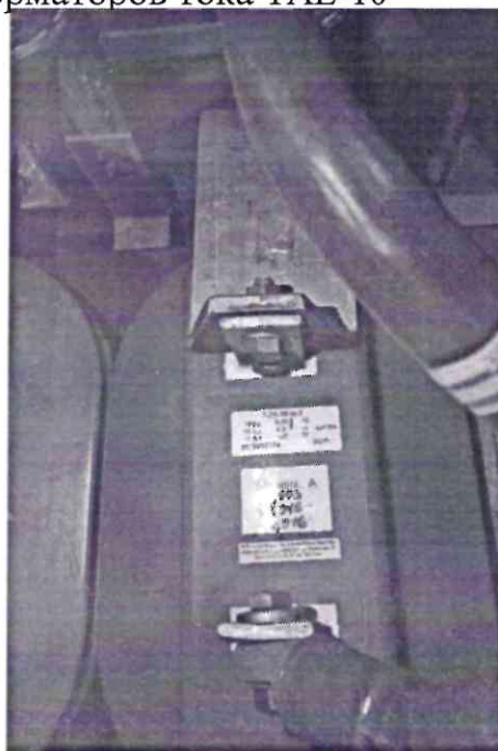
Рисунок 1.7 – Фотография компонентов АСКУЭ при применении трансформаторов тока ТОЛ-10
