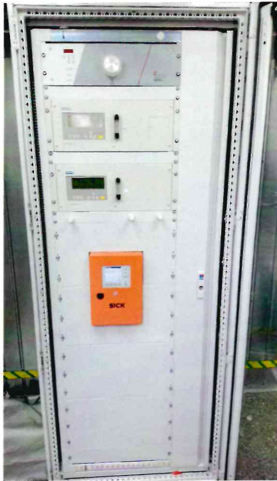
Рисунок 1.7 – Фотография шкафа приборного АСКВ
