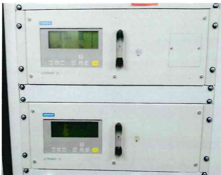
Рисунок 1.1 – Фотография газоанализаторов ULTRAMAT 23
