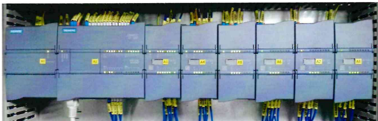
Рисунок 1.6 – Фотография контроллера программируемого SIMATIC S7-1200 с модулями ввода
