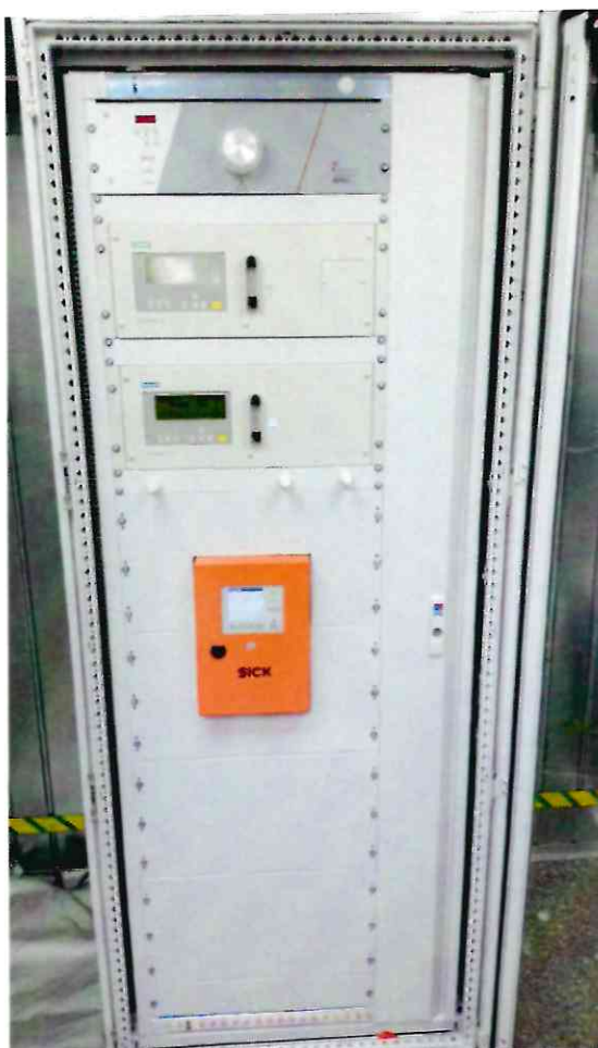
Рисунок 1.7 – Фотография шкафа приборного АСКВ
