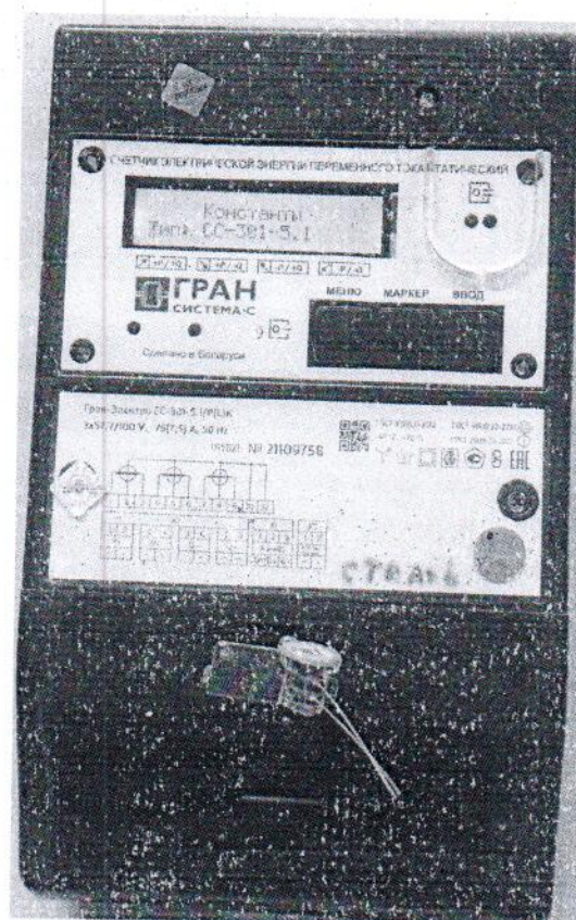
Рисунок 1.4 – Фотография компонентов АСКУЭ при применении счетчиков электрической энергии «Гран-Электро СС-301»
