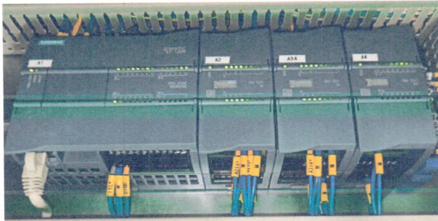
Рисунок 1.7 – Фотография контроллера программируемого SIMATIC S7-1200
