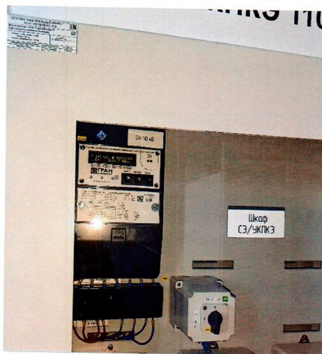
Рисунок 1.4 – Фотографии общего вида счётчиков электроэнергии из состава АСКУЭ
