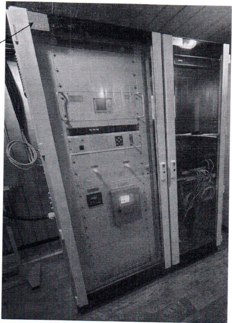
Рисунок 1.7 – Фотография шкафа газового анализа и шкафа сервера с маркировочной табличкой
