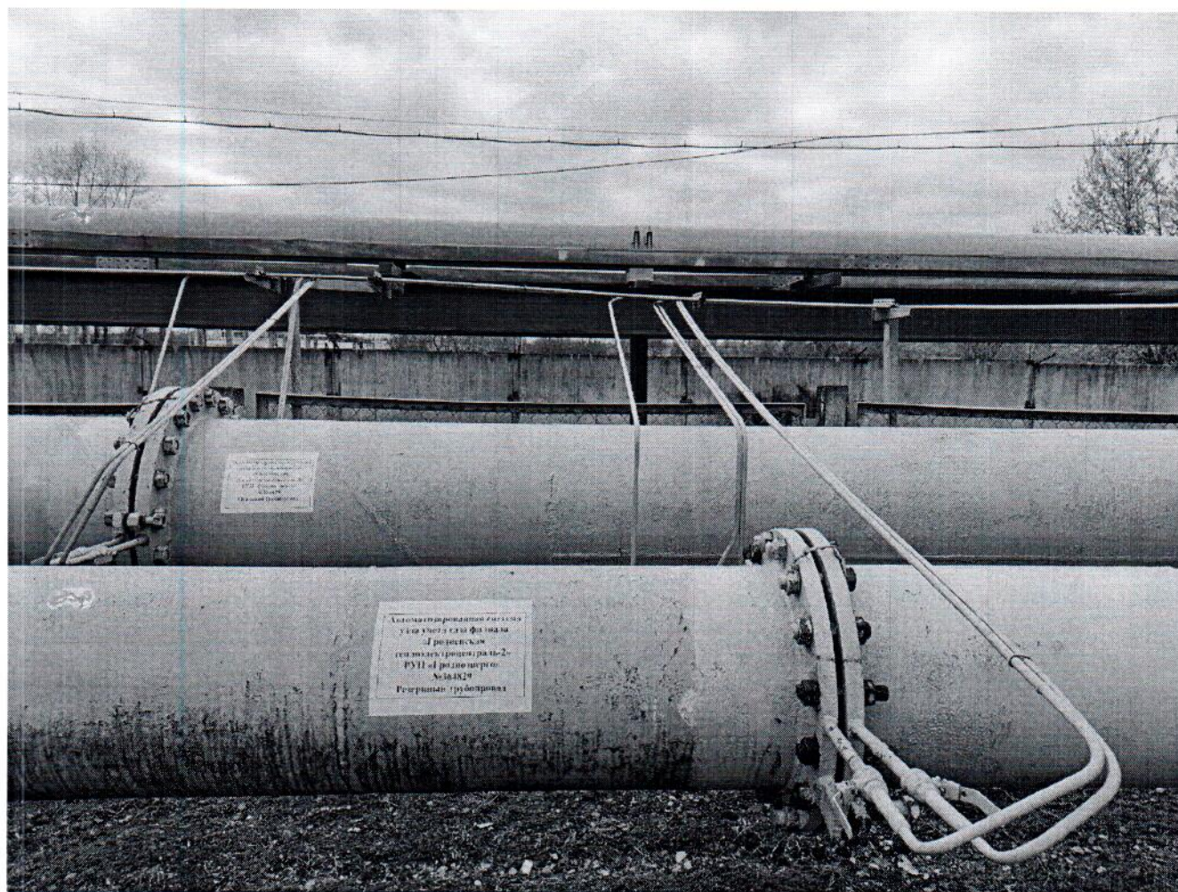
Рисунок 1.4 – Фотография общего вида основного и резервного трубопровода с диафрагмами автоматизированной системы узла учета газа филиала «Гродненская теплоэлектростанция-2» РУП «Гродноэнерго» №364829
