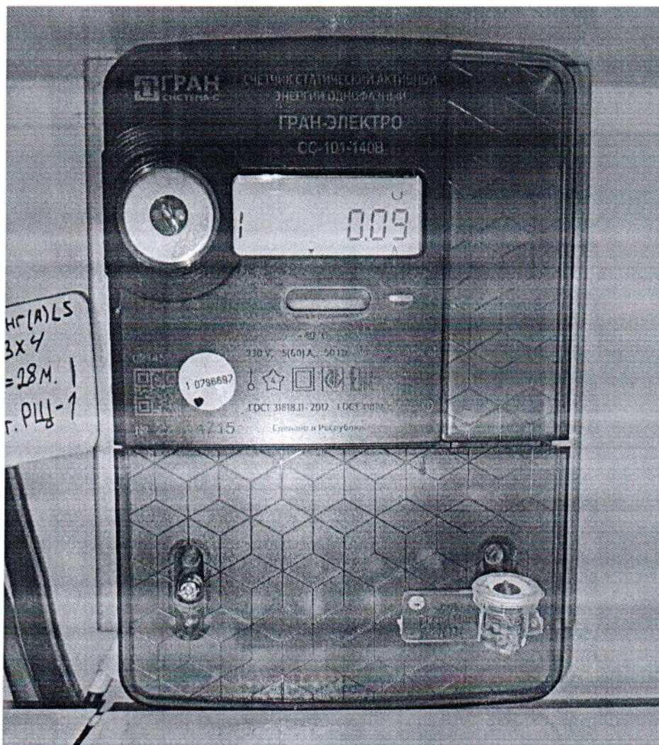
Рисунок 1.4 – Фотография компонентов измерительного канала АСКУЭ при применении счетчик электрической энергии «Гран-Электро СС-101»
