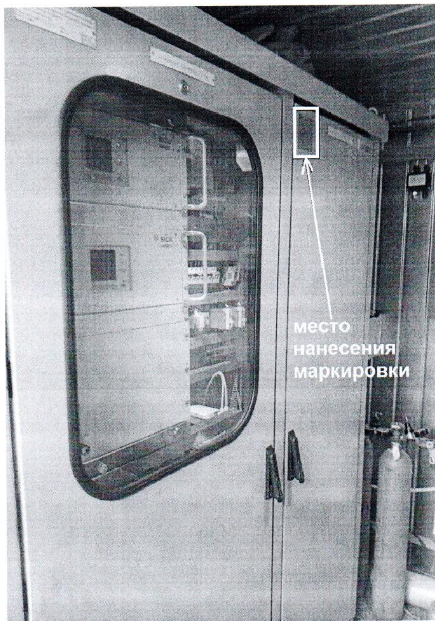
Рисунок 1.7 – Фотография шкафа приборного АСКВ с указанием места нанесения маркировки АСКВ
