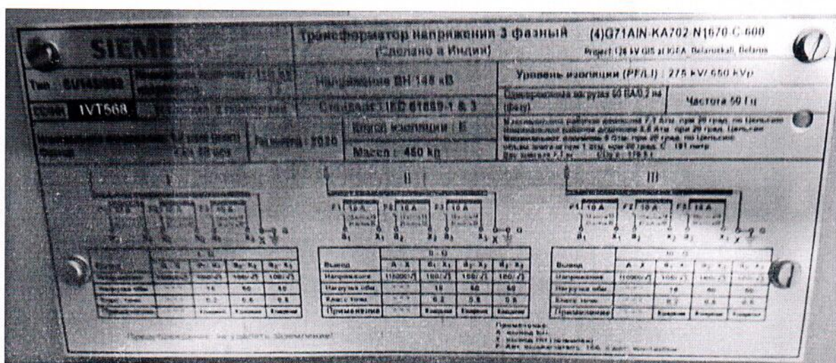
Рисунок 1.2 – Фотография маркировки трансформатора напряжения SU145/S92 № 1VT568
