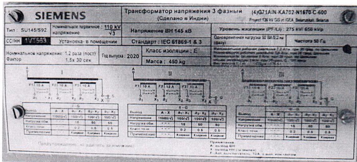
Рисунок 1.2 – Фотография маркировки трансформатора напряжения SU145/S92 № 1VT563
