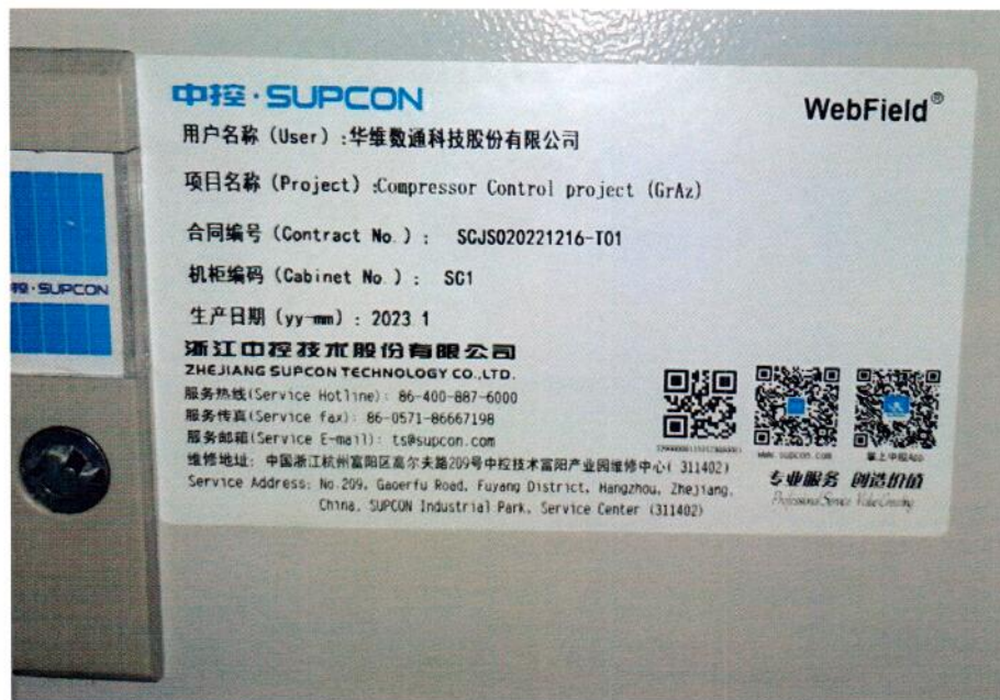
Рисунок 1.3 – Фотография маркировки станции управления (на шкафу управления)
