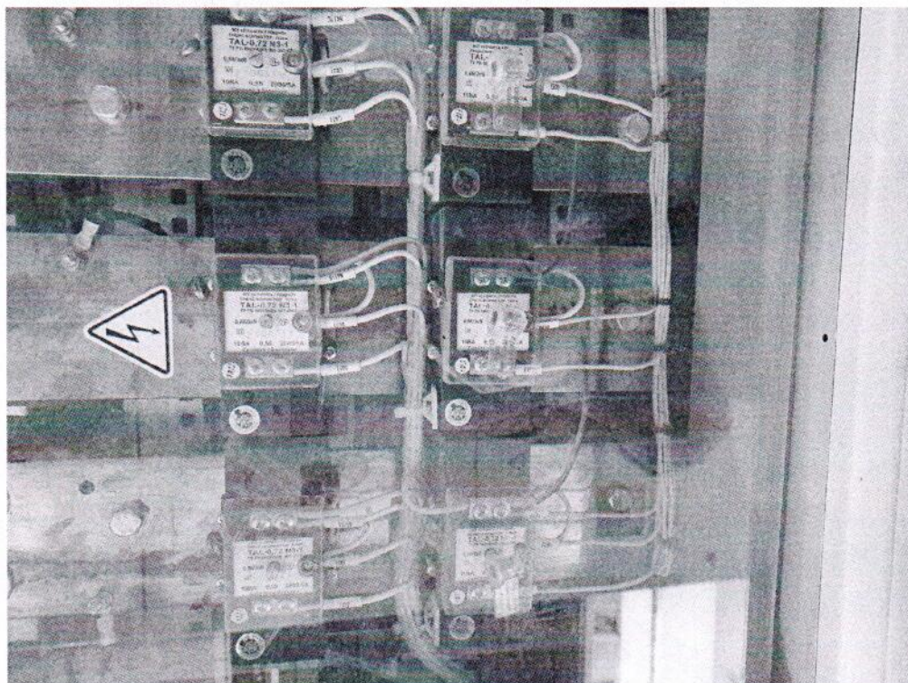
Рисунок 1.4 – Фотография компонентов АСКУЭ: трансформаторы тока TAL-0.72 N3-1
