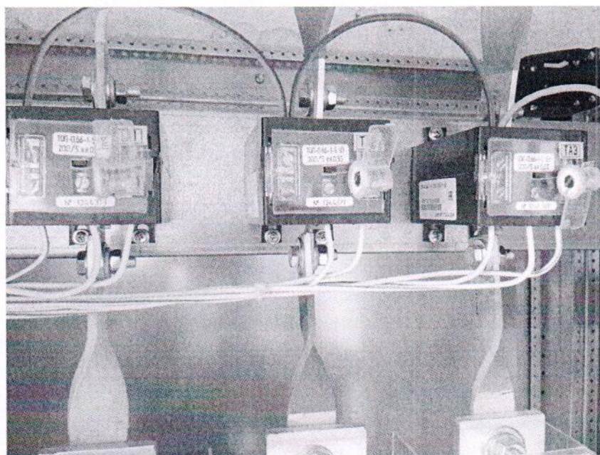
Рисунок 1.4 – Фотография компонентов АСКУЭ при применении трансформаторов тока ТОП-0,66
