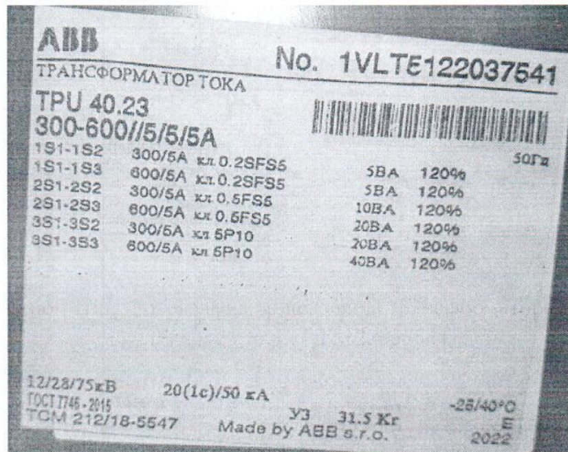
Рисунок 1.2 – Фотография маркировки трансформатора тока TPU 40.23 № 1VLT5122037541
