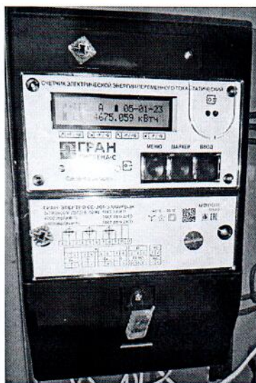
СС-301-5.1/U/P(L)К ИК № 7 Станция обезжелезивания Ввод 1
