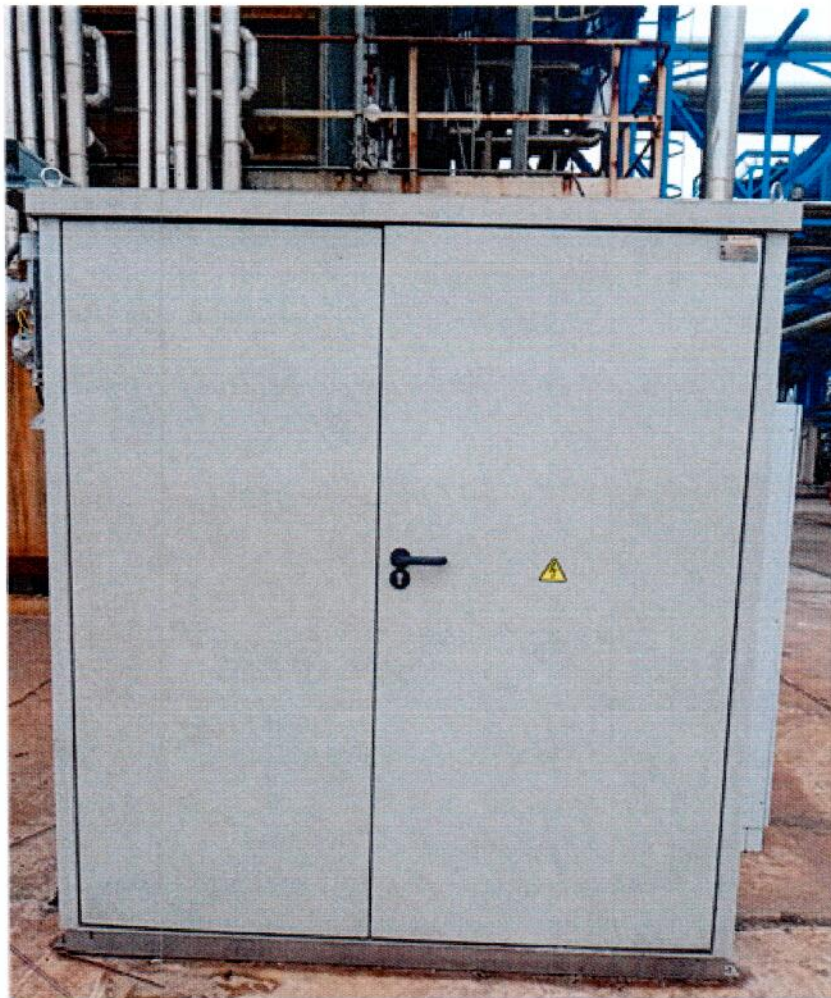
Рисунок 1.10 – Фотография шкафа управления системы газоаналитической промышленной взрывозащищенной PromIS GA Ex № 292
