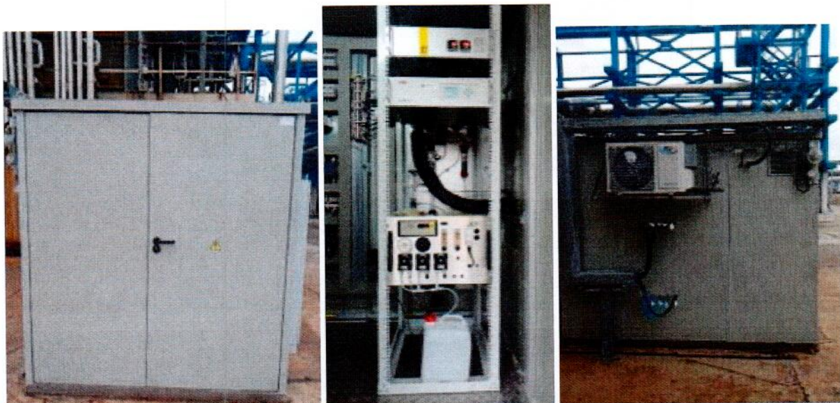
Рисунок 1.5 – Фотографии общего вида комплектного блока-контейнера системы газоаналитической промышленной взрывозащищенной PromIS GA Ex № 292
