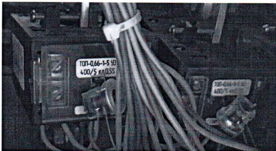
Рисунок 3 – Фотография компонентов АСКУЭ при применении трансформаторов тока ТОП-0,66
