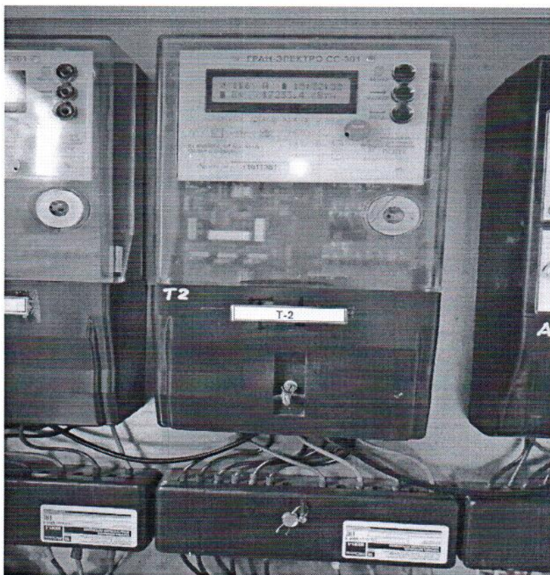
Рисунок 2 – Фотография компонентов АСКУЭ при применении счетчиков электрической энергии переменного тока трехфазных статических СС-301
