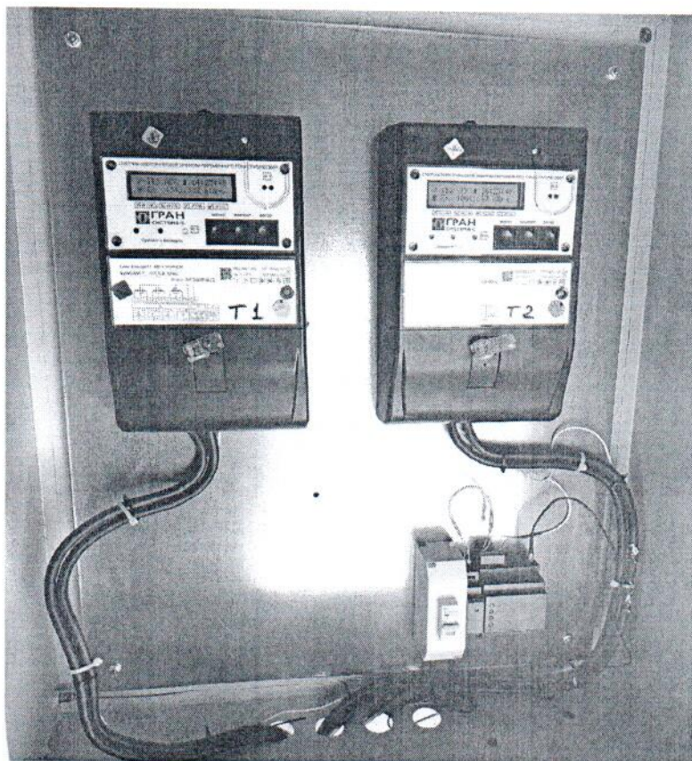
Рисунок 2 – Фотография компонентов АСКУЭ. Счетчики электрической энергии переменного тока трехфазные статические СС-301-5.1/U
