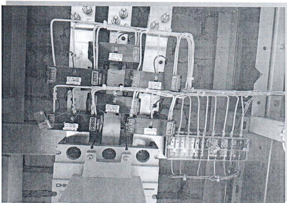
Рисунок 3 – Фотография компонентов АСКУЭ. Трансформаторы тока ТШП-0,66
