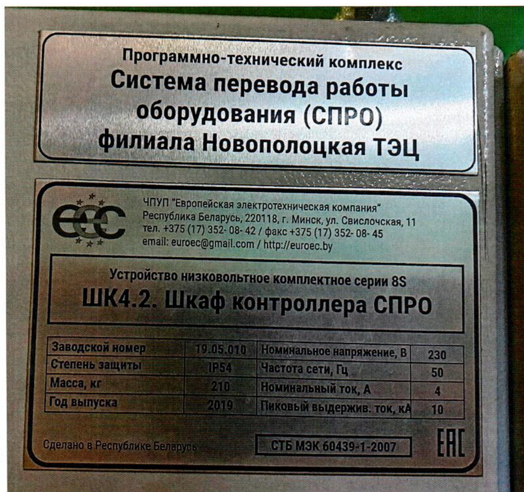
Рисунок 2 – Фотографии маркировки шкафов АСУ ТП
